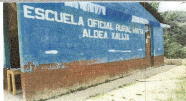
Foto 8: Pintura exterior dañada por el tiempo que lleva de uso, se requiere nueva pintura en (modulo 1) 19.84X14.74 mts.
