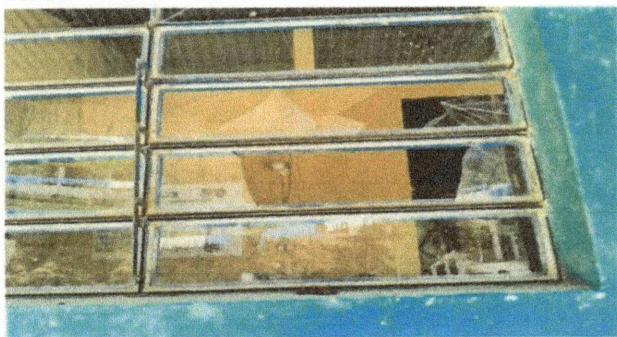
Foto 7: Vidrios quebrados que necesitan ser sustituidos por nuevos, en (modulo 1)
