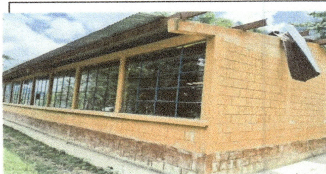
Foto 2: En el modulo 2, necesita remozamiento de estructura y techo, pintura interior y exterior (modulo 2) 23.45x9.95 mts.
