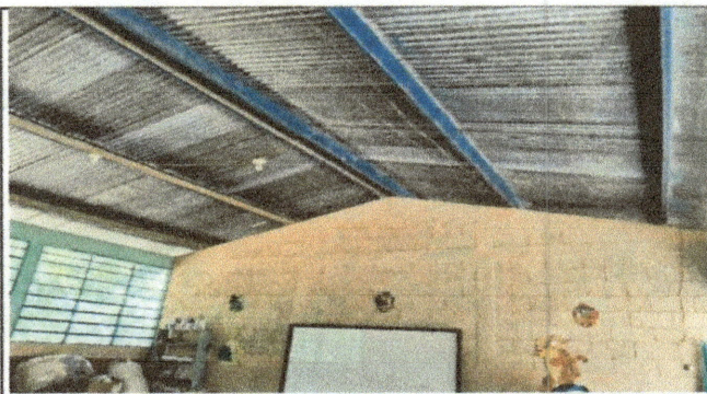
Foto 10: Cableado eléctrico dañado, se requiere sustitución de toda la instalación eléctrica (modulo 2)
