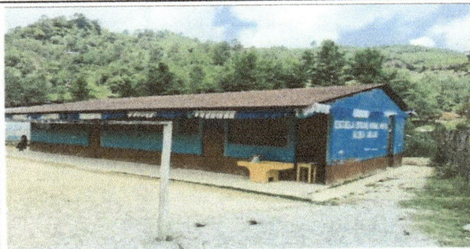
Foto 1: Se observa el entechado en mal estado que requiere ser sustituido (modulo 1) 19.84X14.74 mts.
